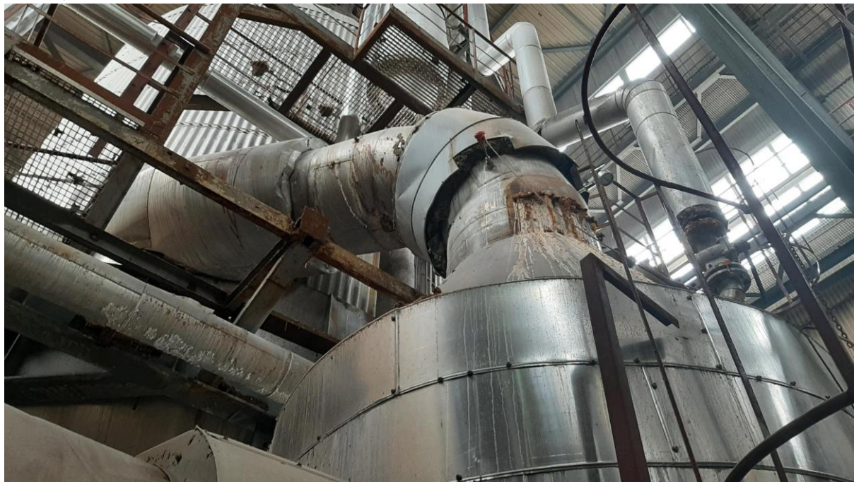
Załącznik 3. Fotografia – rurociąg/kolektor tłoczny pompy P-922A numer techn. ER-307-SMO-900 z end cap.
