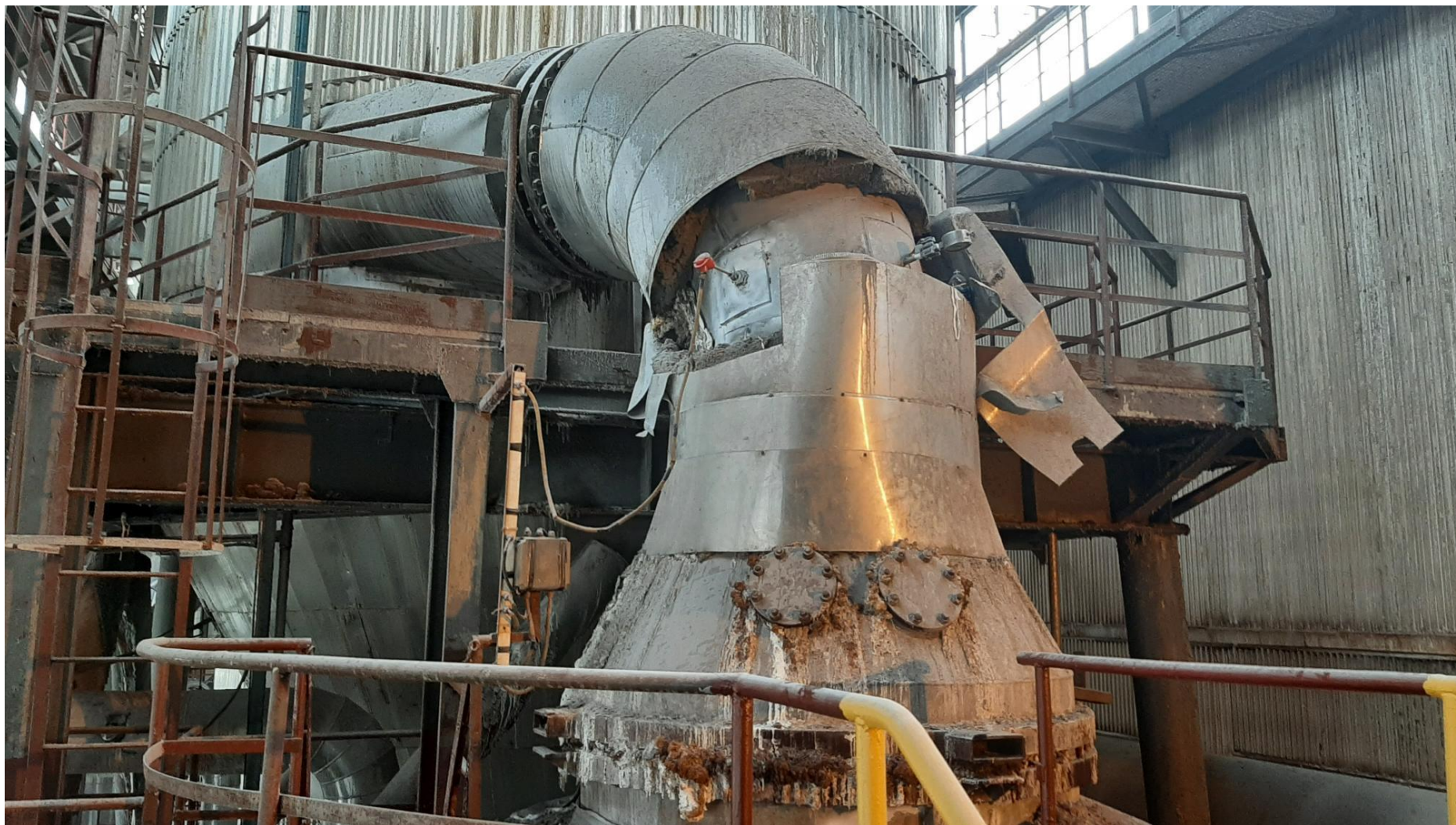
Zał. 4. Fotografia – rurociąg/kolektor tłoczny pompy P-922B numer techn. ER-304-SMO-900
