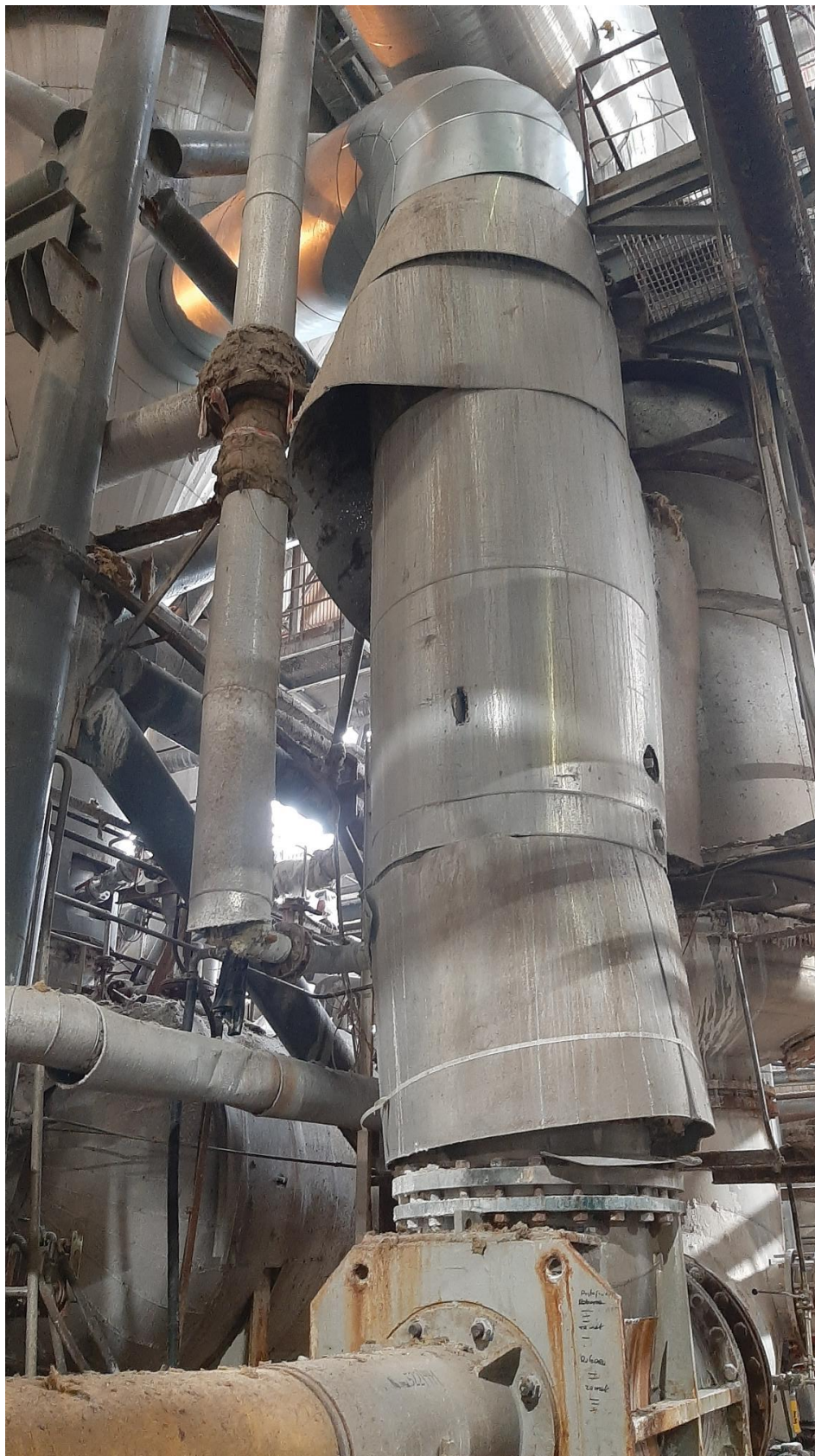
Zał. 1. Fotografia – rurociąg/kolektor ssący pompy P-922A nr techniczny elementu ER-305-SMO-900
